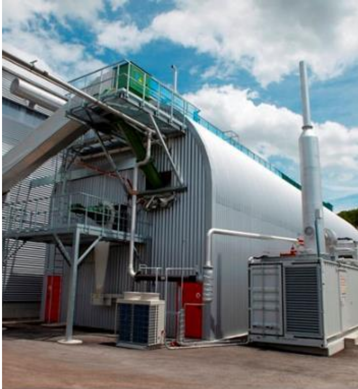
Μονάδα Βιολογικής Επεξεργασίας με Αναερόβια Χώνευση. Ζυρίχη– Ελβετία. Κατασκευαστής HZI
